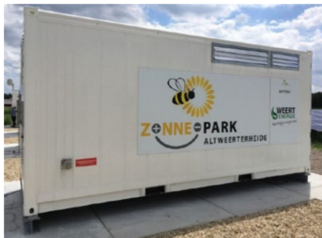
Figuur 3: De batterij met aan deze zijde de borden, aansluiting voor bluswater en ventilatierooster
