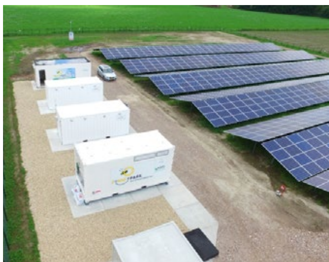
Figuur 2: Deel van zonnepark Altweerderheide met de containers waarin de batterijen, omvormers en vergaderruimte te vinden zijn.
